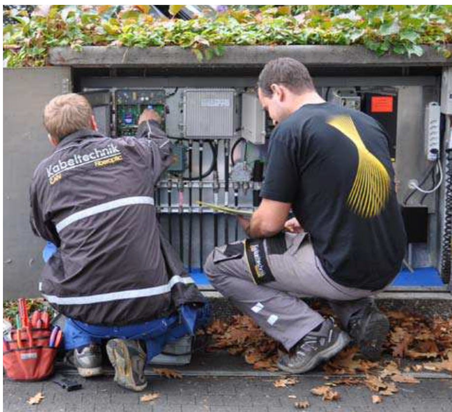
Kabinenumbau im Kommunikationsnetz der IBB ComNet AG
