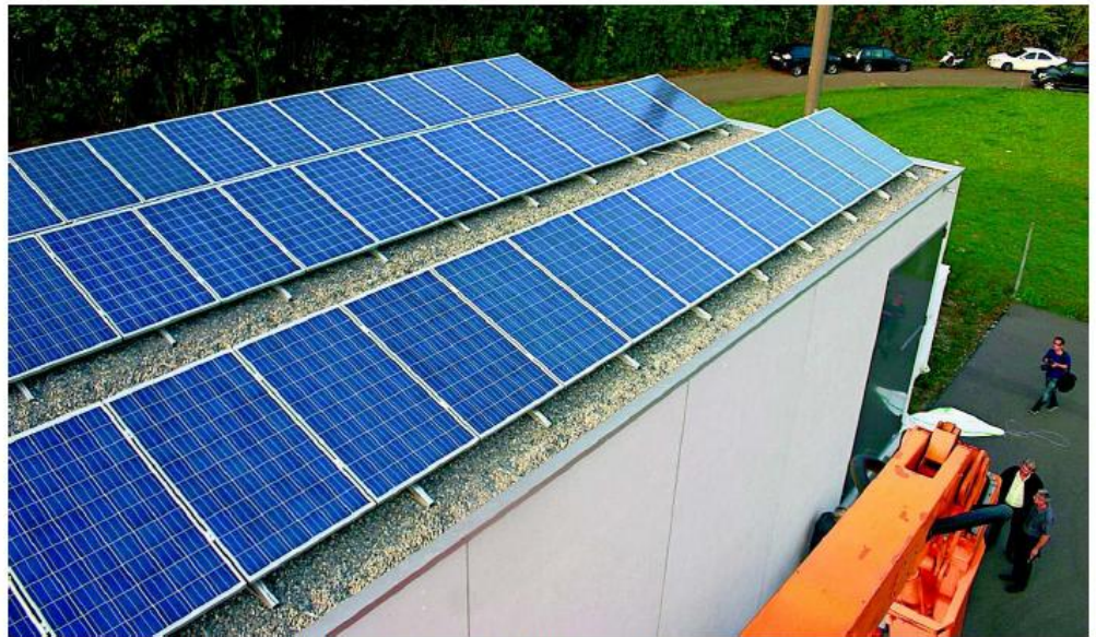
Auf dem Dach des Unterwerks Lupfig produziert die IBB Strom AG jetzt Solarstrom.
